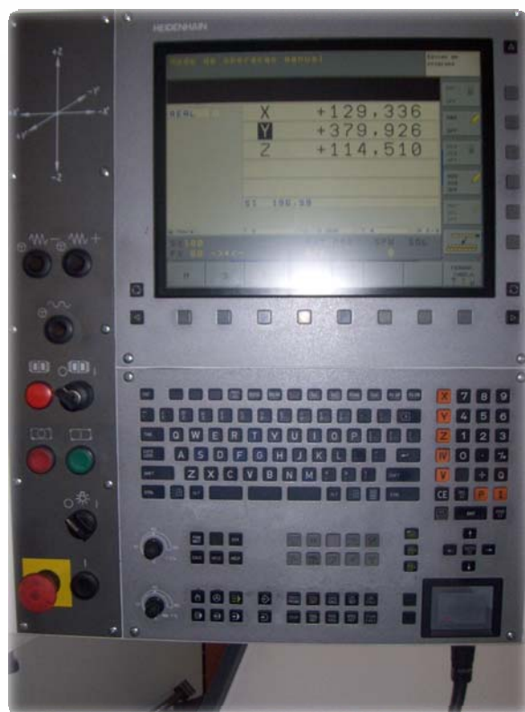
Painel de comando
